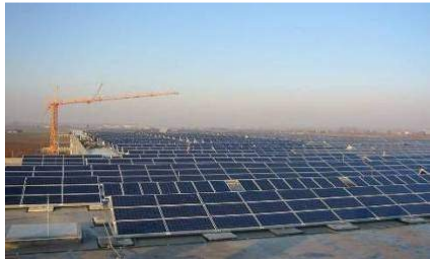
Dachanlage Biebesheim; Gesamtleistung 951 kWp
